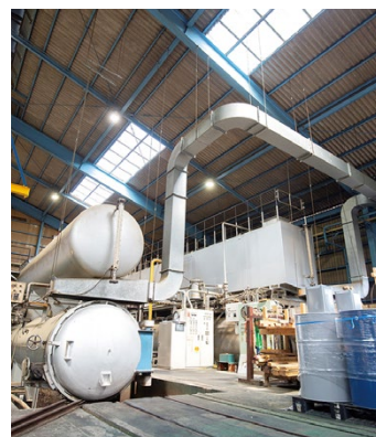
岡山県内で唯一の、木材保存処理加工専門工場。巨大な筒状の真空釜の中に木材を入れ、圧力をかけて処理薬剤を浸透させる
