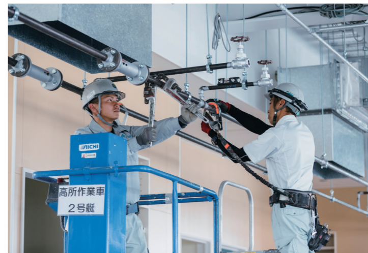
こうした配管の多くは、建物が完成すれば人目にふれることはほとんどないが、建物を快適に利用するために欠かせないもの。設計・施工からメンテナンスまで、有資格技術者が責任をもって手がけている
